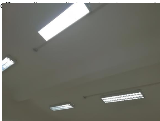
Figura 4.13 - Particolare dei corpi illuminanti ubicati nel refettorio
