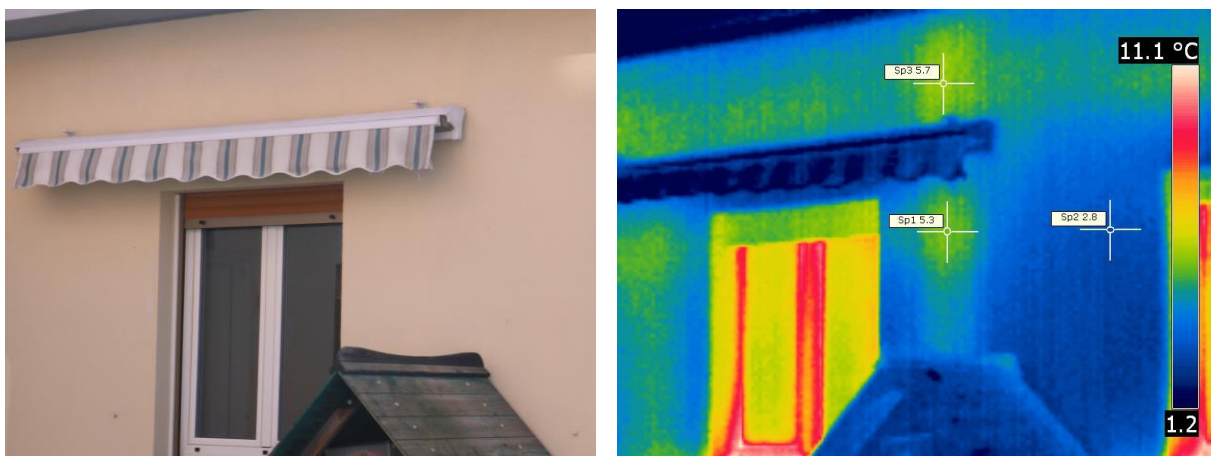
Figura 4.5 – Rilievo termografico dei serramenti zona refettorio e cucina
