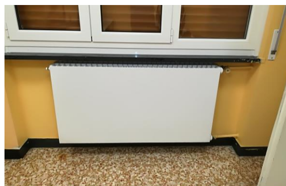
Figura 4.6 - Particolare dei radiatori installati sulle pareti esterne degli ambienti
