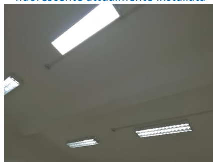
Figura 8.11- Particolare di una lampada fluorescente attualmente installata
