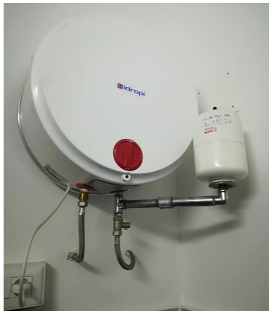
Figura 4.12 - Particolare di un boiler elettrico per la produzione di acqua calda sanitaria
