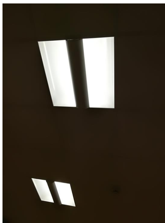
Figura 4.14 - Particolare dei corpi illuminanti ubicati nelle aule
