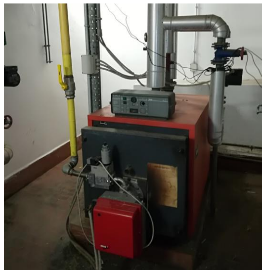
Figura 8.9 - Particolare del generatore di calore attuale
